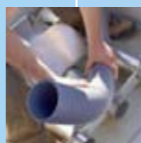
ACTREAD Environnement : Mise en place du système d'alimentation pour station d'épuration à filtre planté de roseaux.
